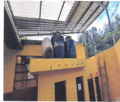
FOTO NO 3.1 TINACO E INSTALACION DE AGUA
